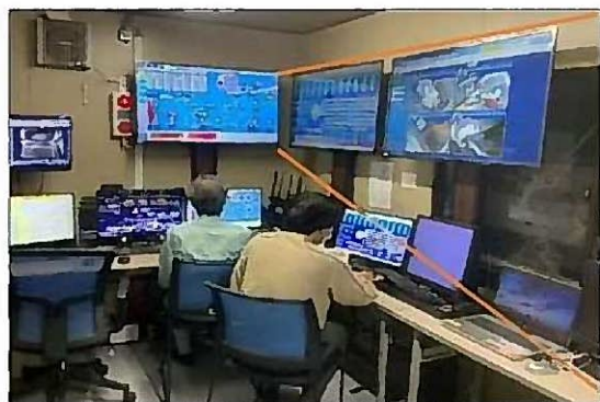
中央監視室での掘進管理 (発進基地(落合水再生センター内))
