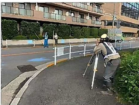
路面変状計測
