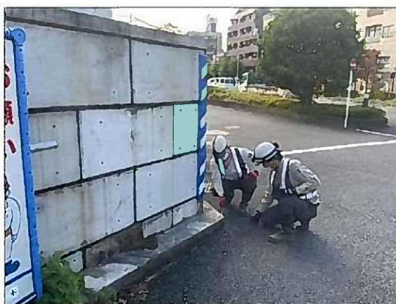
路面変状監視
