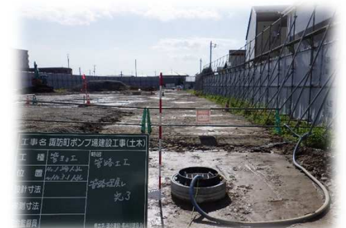
H29.7~10 手前に見えるのが新しい雨水のマンホールです。
